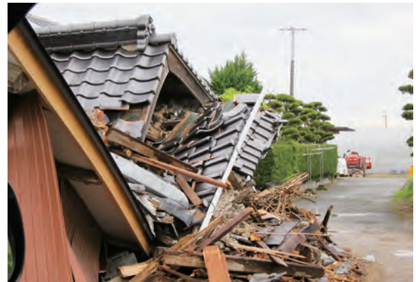
Fig.15 全壊した家屋（南区でも益城町に近い地域にて）
